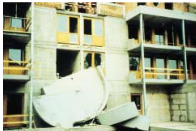
Grobe Mißachtung technischer Baubestimmungen
